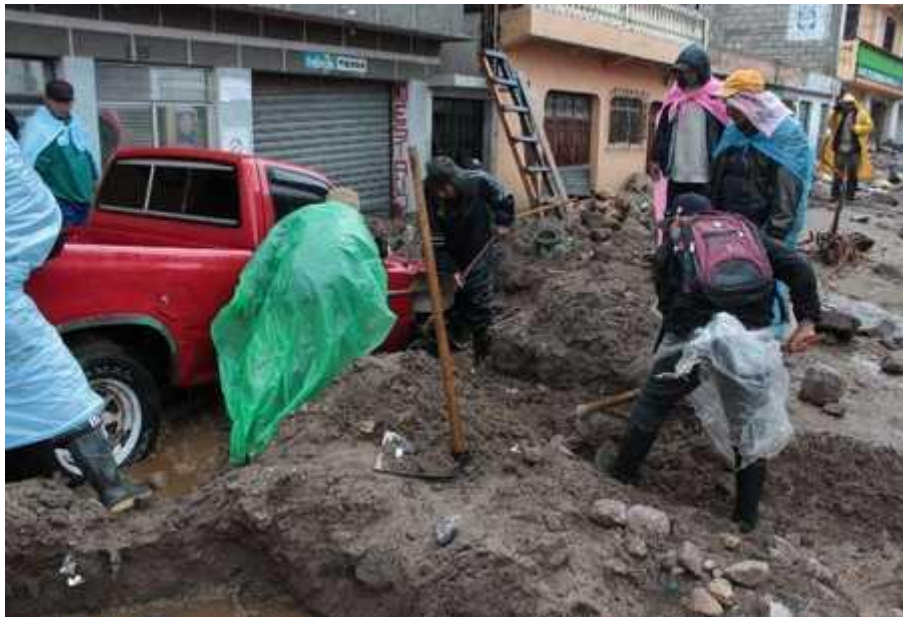
• Vecinos despejan una vía y desentierran uno de decenas de vehículos que fueron destruidos por las fuertes correntadas de rocas y lodo (Foto Prensa Libre: EFE)
